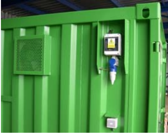
Porte AR : Electricité aux normes Européennes
